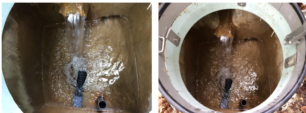
Illustration 17 : Captage « Les Bernières » (photographie : Thibaut Courtieu, ATESYN)
